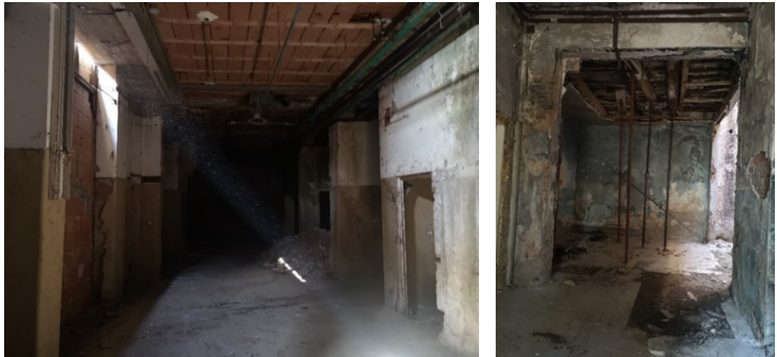
Figure 39 e 40: Ulteriori immagini che testimoniano l'avanzato stato di degrado
