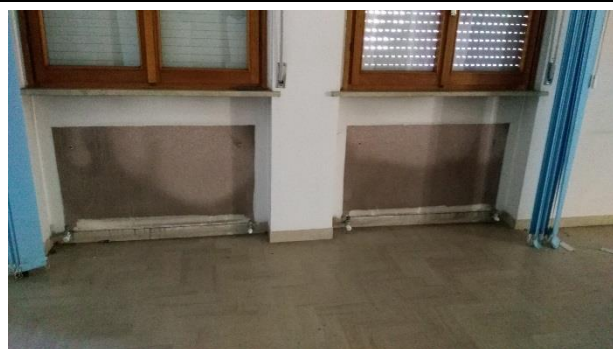
Piano primo – radiatori distaccati
