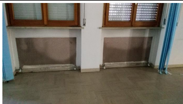
Piano primo – radiatori distaccati
